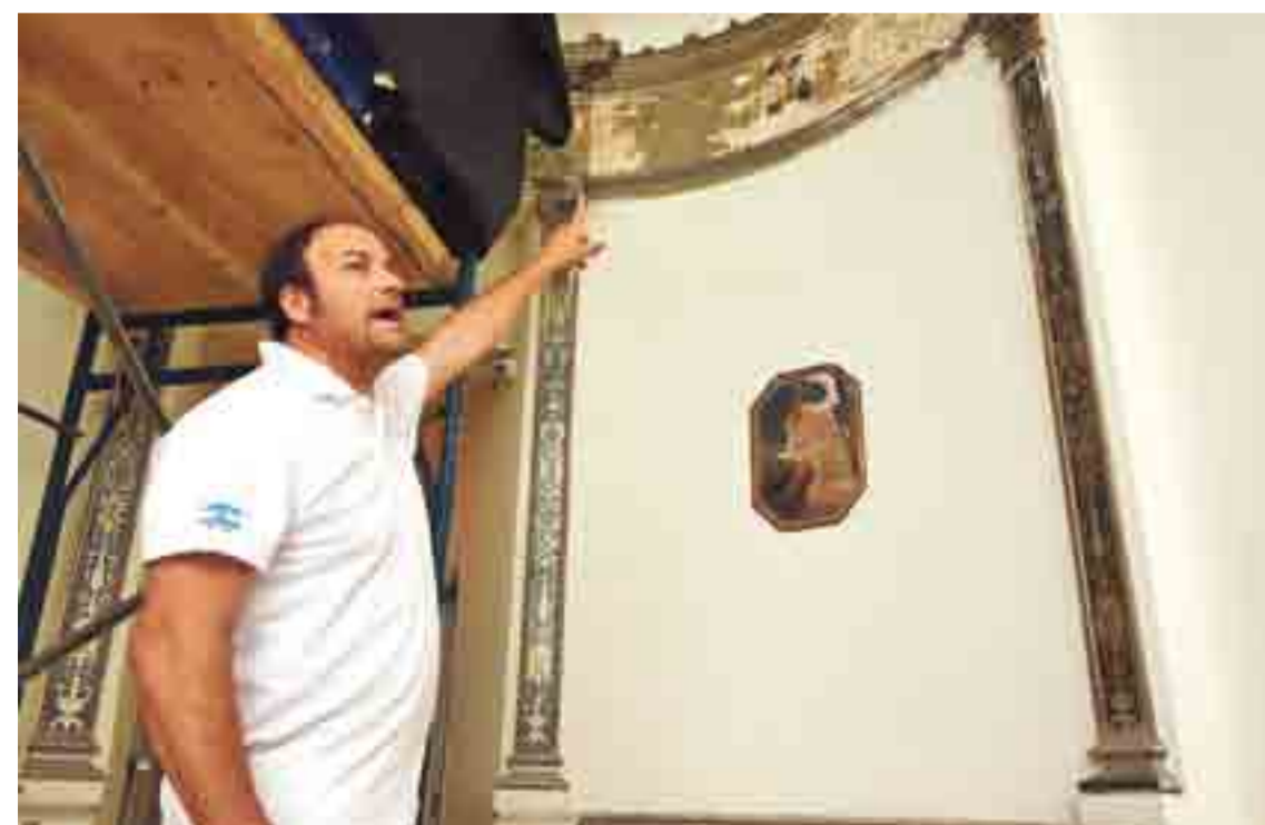
"Parte del trabajo consiste en remover piezas para reproducirlas y completar las ornamentaciones superiores", contó el restaurador Mauro Fornari. FOTO: GUILLERMO DI SALVATORE
